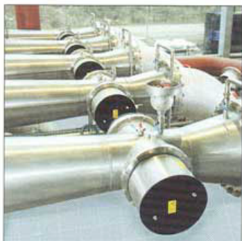
UV-dezinfekce pitné vody Průtokové množství: 7000m 3 /h
