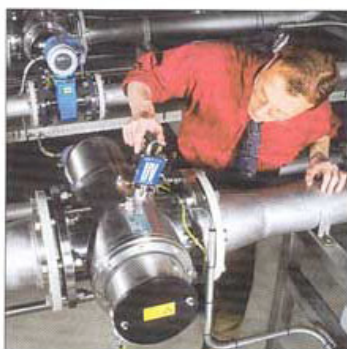
UV- úprava provozní vody
